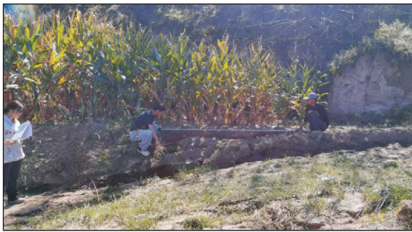
a 道路汇水造成的侵蚀
