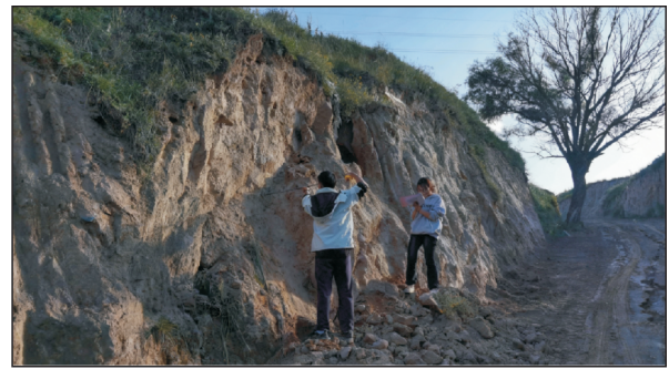
b 边坡侵蚀
